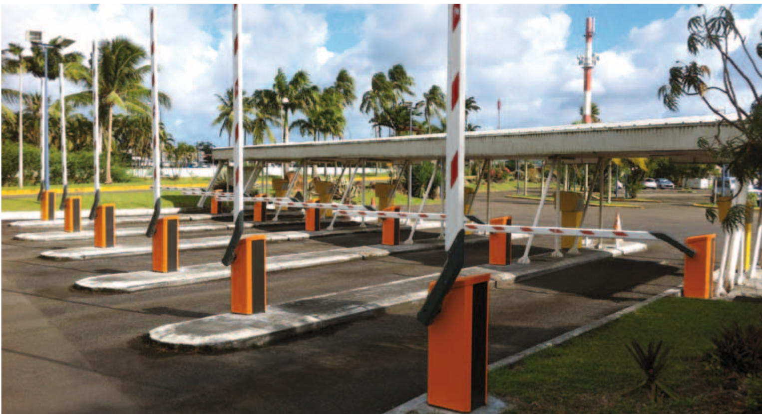
Шлагбаумы Magnetic.Parking на шлюзах в аэропорту Fort-de-France (Мартиника).
